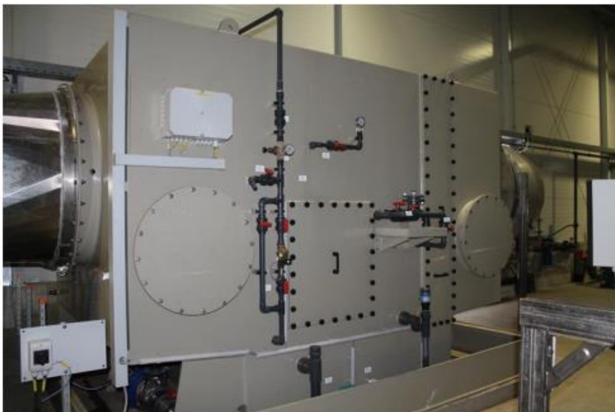
Zdjęcie 1. Oczyszczacz powietrza wywiewanego – instalacja wewnętrzna (zdjęcie podglądowe)
