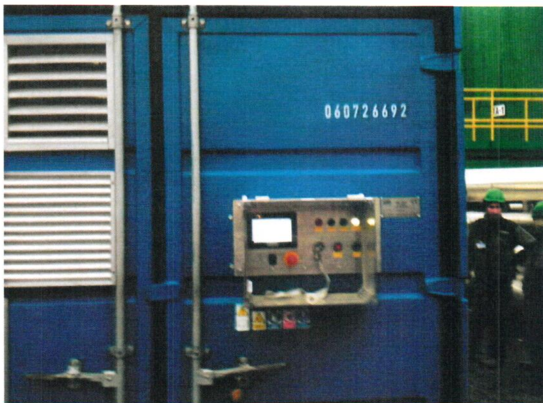
2. Terminal asfaltów drogowych TOTAL Polska w Ścinawie - Urządzenie do likwidacji odorów.
